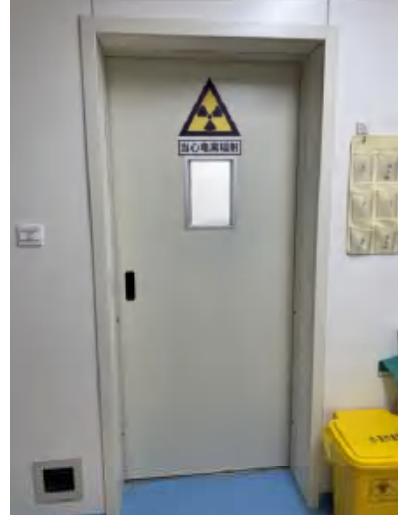
操作间防护门、电离辐射警告标志
